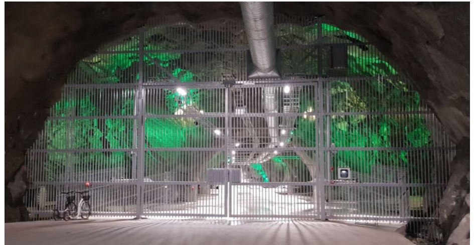
Le Lefdal Mine Datacenter en Norvège. Source : Lefdal
